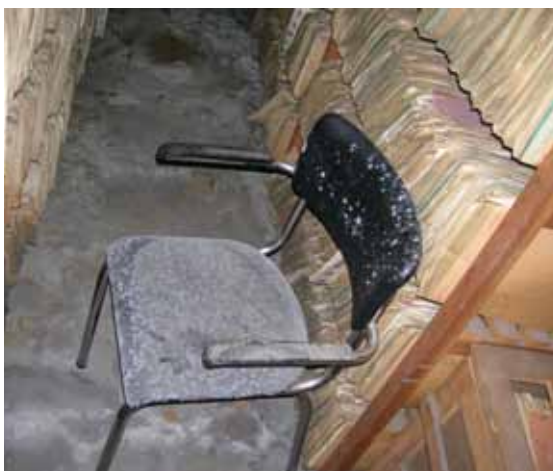
Aantasting van de lokalen en het meubilair door schimmels
